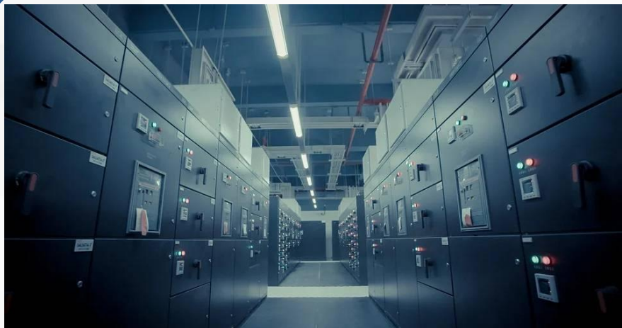
上海商飞数据中心配电
