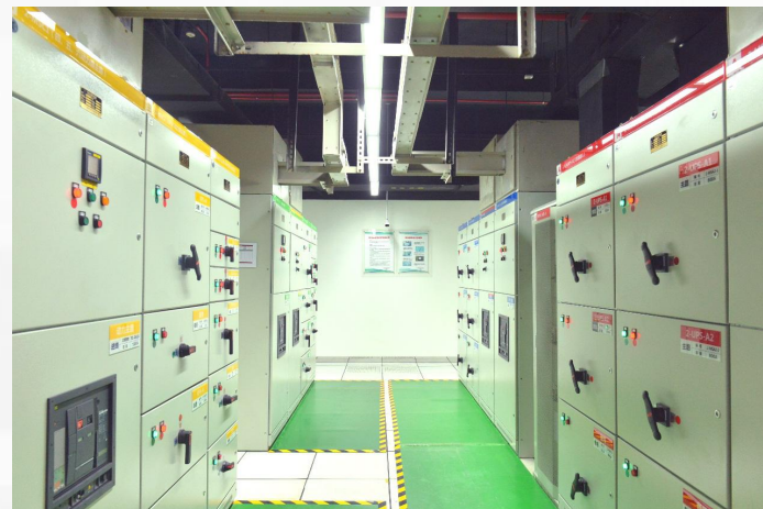
中交云数据中心
