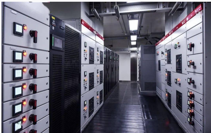
长沙联通数据中心
